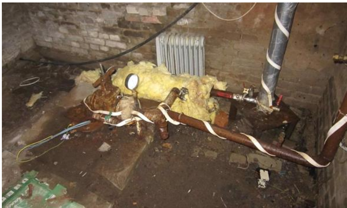
Рисунок 1.1.4.1-2 Внутренний вид павильона скважины в д. Ломаха
